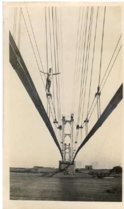
Un ouvrier équilibriste sur le pont de Deir ez-Zor (Syrie) en cours de construction, 1925-1931. 50 Fi 88, fonds Arnodin – Leinekugel Le Cocq, Archives de Brive.
